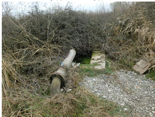
故障している井戸
