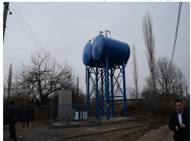
プロジェクトにより建設された高架水槽
